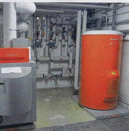
Bei der Steuerung des neu installierten Erdgas-Brennwertkessels werden die tatsächlichen Nutzungszeiten der Turnhalle berücksichtigt.
