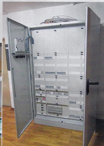
Über die tageslichtabhängige Steuerung der Hallenbeleuchtung kann Energie und damit Geld gespart werden.
